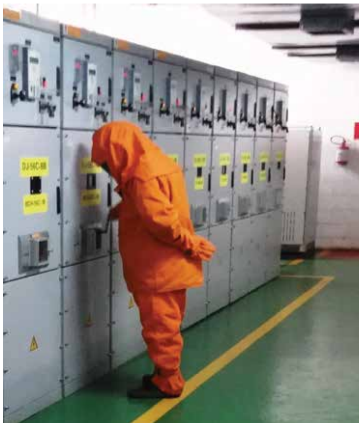
Figura 3 – Operação de disjuntor de média tensão (AT) em uma indústria.
