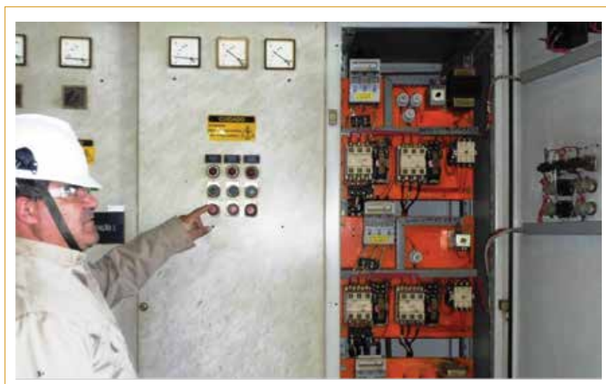
Figura 4 – Operação BT e equipamento “descompartimentado”.
