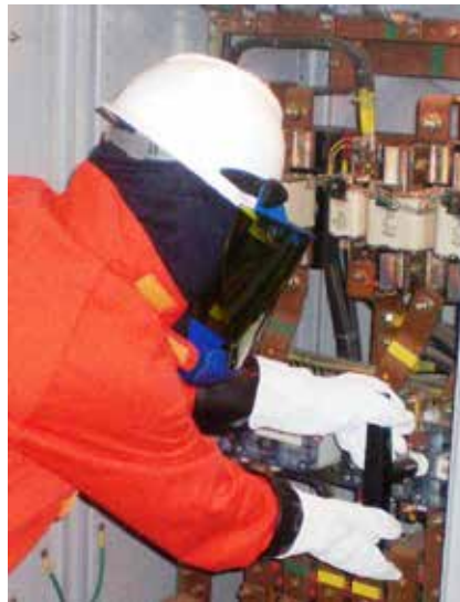
Figura 3 – Atividade em painel de BT.
