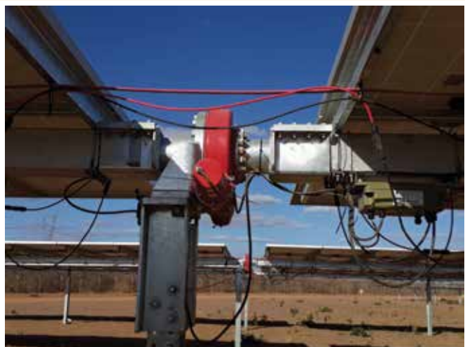
Sistema de motor elétrico para movimentação dos módulos de geração
