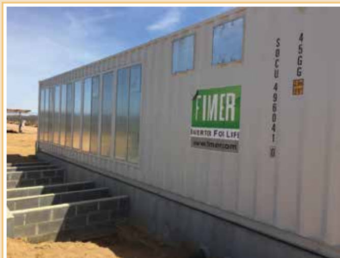
Eletocentros para instalação dos inversores
