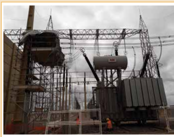
Subestação de 500 KV com 2 transformadores de 245MVA cada
