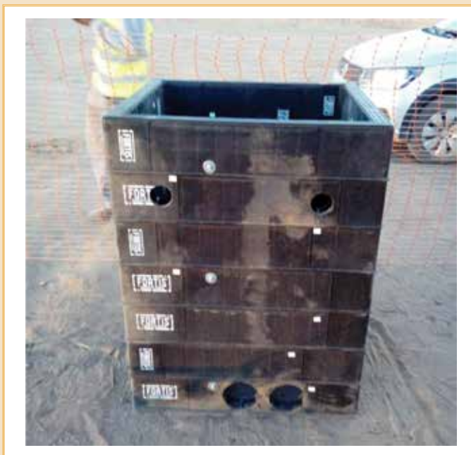
Utilização de caixas de passagem de cabos de BT em PVC
