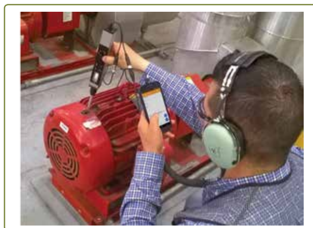
Figura 3 – Um técnico de ultrassom usa o InCTRL com o CTRL UL101 para ouvir um rolamento do motor do ventilador.
