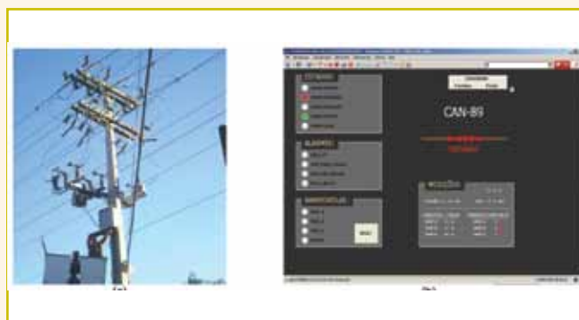
Figura 6 – (a) Chave telecomandada (b) Tela do sistema SCADA para operação das chaves telecomandadas.
