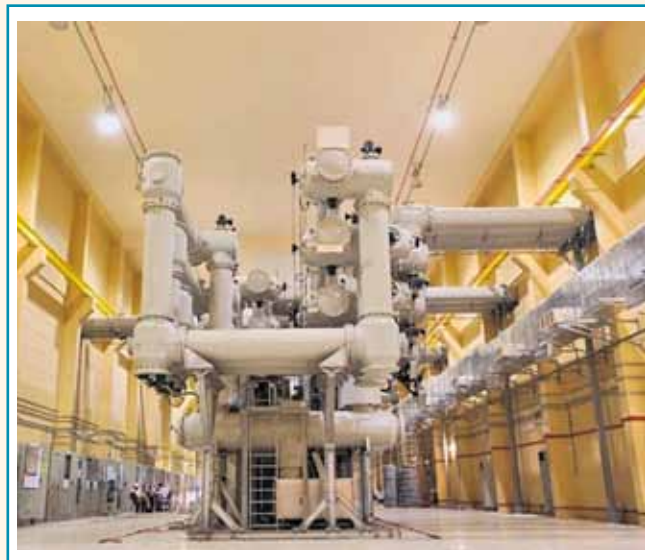
Figura 5 – Subestação compacta GIS (gas-insulated substation), gás SF 6 , de 400/132 kV em Abu Dhabi. Fonte: http://www.emirates247.com
