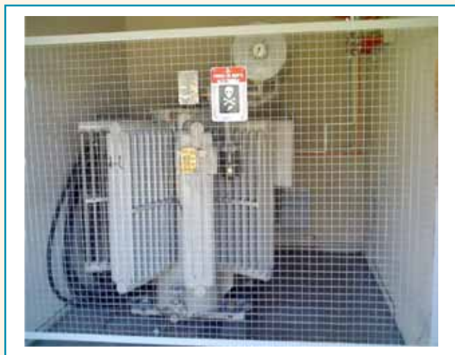
Figura 8 - Transformador em cabine primária particular.
