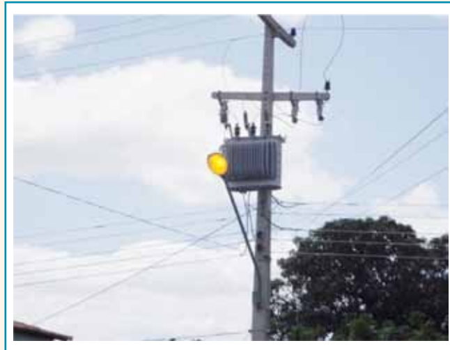
Figura 9 - Poste de rua que suporta sistema de média tensão no alto, transformador trifásico, sistema de baixa tensão abaixo e iluminação pública.
