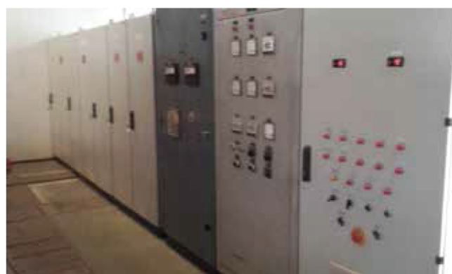
Figura 2 - Painéis elétricos de baixa tensão.
