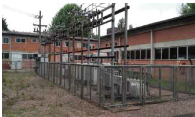
Figura 1 - Subestação de energia em 13,8 kV.
