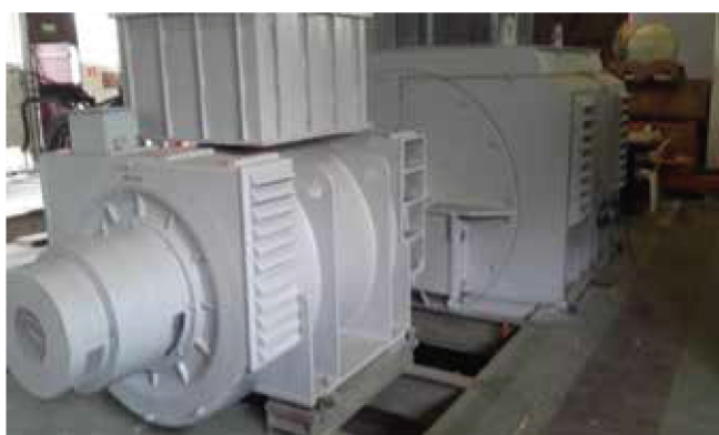
Figura 3 – Grupo motor-gerador utilizado em instalações industriais.
