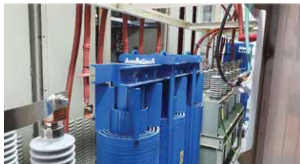
Solução em contêiner – 7 Mvar. Fonte: Elspec
