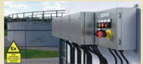
Exemplo de instalação de painel local de controle “Ex” e caixas de junção “Ex”, em áreas classificadas contendo a presença de atmosferas explosivas, formadas por gases inflamáveis ou poeiras combustíveis.
