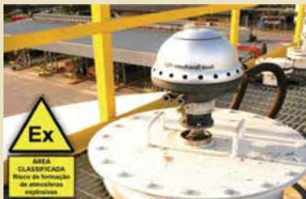
Exemplo de instalação de equipamentos “Ex” para instrumentação, em áreas classificadas contendo a presença de atmosferas explosivas, formadas por gases inflamáveis ou poeiras combustíveis.
