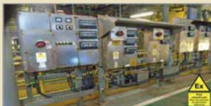
Exemplo de instalação de painéis “Ex” para a distribuição de circuitos de força e controle, em áreas classificadas contendo a presença de atmosferas explosivas, formadas por gases inflamáveis ou poeiras combustíveis.
