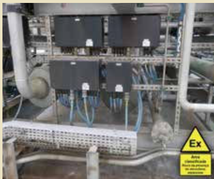
Exemplo de instalação de caixas de terminais Ex “e” (segurança aumentada) em áreas classificadas contendo a presença de atmosferas explosivas, formadas por gases inflamáveis ou poeiras combustíveis.
