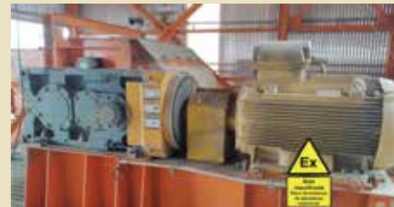
Exemplo de instalação de conjunto motor + caixa de engrenagens, contendo equipamentos elétricos e mecânicos “Ex” em áreas classificadas, contendo a presença de atmosferas explosivas formadas por gases inflamáveis ou poeiras combustíveis.
