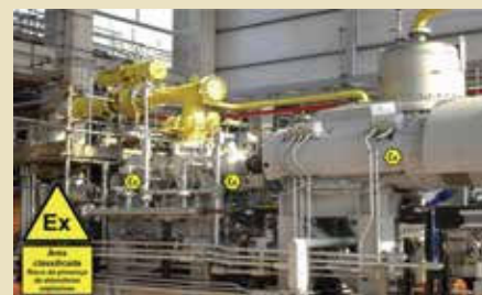
Exemplo de instalação de conjunto moto-compressor contendo equipamentos elétricos e mecânicos “Ex”, em áreas classificadas com a presença de atmosferas explosivas, formadas por gases inflamáveis ou poeiras combustíveis.
