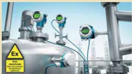
Exemplo de instalação de instrumentos transmissores intrinsecamente seguros (Ex “i”), em áreas classificadas contendo a presença de atmosferas explosivas, formadas por gases inflamáveis ou poeiras combustíveis.
