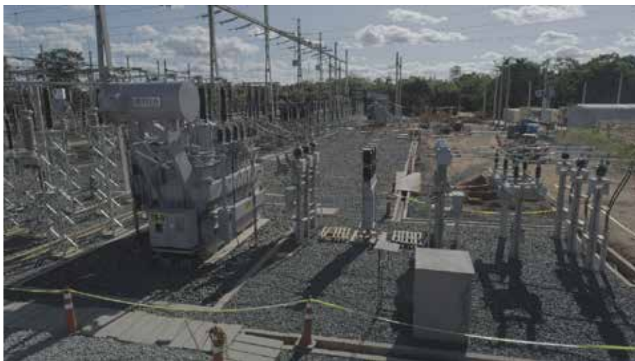
Com 30 MW de potência, os sistemas de armazenamento são capazes de entregar 60 MWh de energia por duas horas. Imagem: Divulgação/ISA CTEEP
