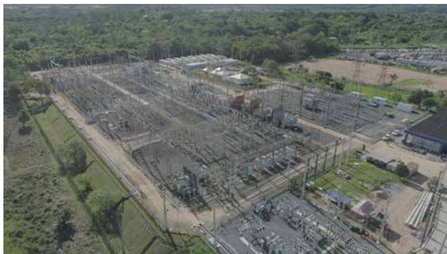
O empreendimento conta com mais de 180 racks de baterias de lítio instalados em uma área de aproximadamente 5 mil m 2 , o equivalente à metade de um campo de futebol. Imagem: Divulgação/ISA CTEEP
