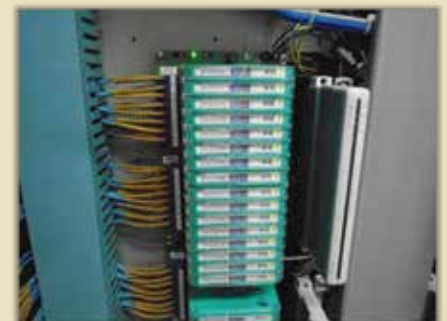
Figura 4 – Exemplo de painel contendo barreiras de segurança intrínseca (Ex “i”), com isolamento galvânica entre os sinais de campo em áreas classificadas e sinais de interface com sistema de controle, integrados no mesmo armário contendo a CPU e pontos de I/O do DCS (Digital Control System).
