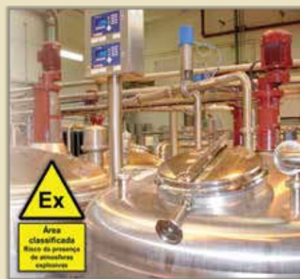
Figura 3 – Exemplo de instalação de equipamentos medidores e de painel local de medição e controle, com proteção por segurança intrínseca, adequado para instalação em áreas classificadas Zona 1 (Ex ib IIC Gb) e Zona 21 (Ex ib IIIC Db).
