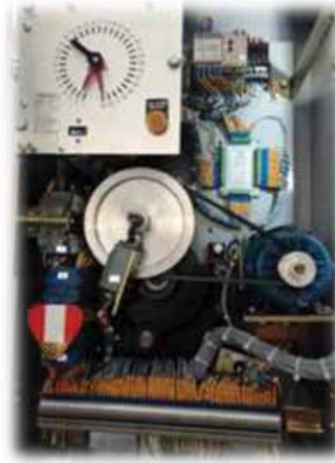
Figura 3 – Mecanismo de comando do comutador de derivações em carga.
