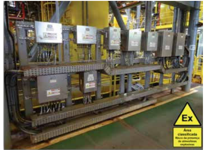
Exemplo de caixas de terminais ou painéis locais de controle com tipos de proteção combinados Ex “db eb mb”, instalados em áreas classificadas, com a instalação de cabos de aterramento e de equipotencialização.
