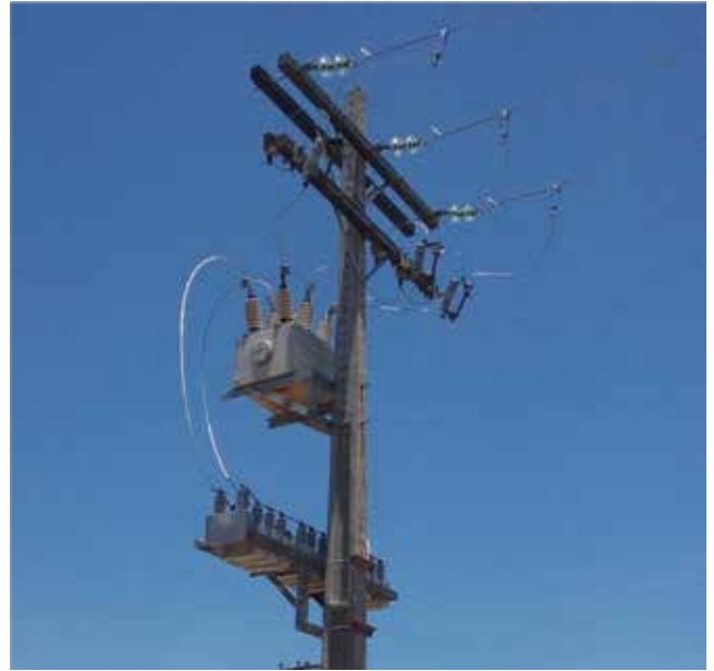
Figura 8 – Banco de capacitores com religador à montante.
