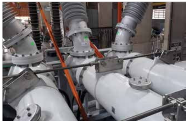
Figura 6 – Módulo híbrido compacto instalado sobre subestação móvel.
