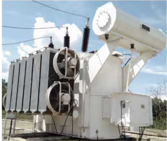
Figura 1 – Transformador de força.
