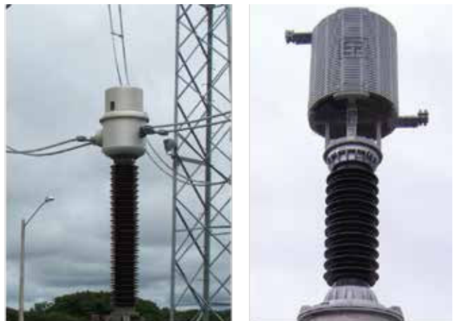
Figura 3 – Transformadores de instrumentos – TC à esquerda e TP à direita.
