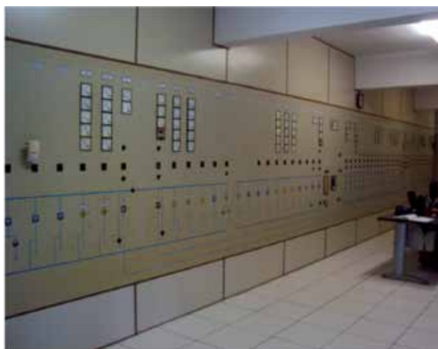
Figura 1 – Perfil de monitoramento visual e local nas subestações.
