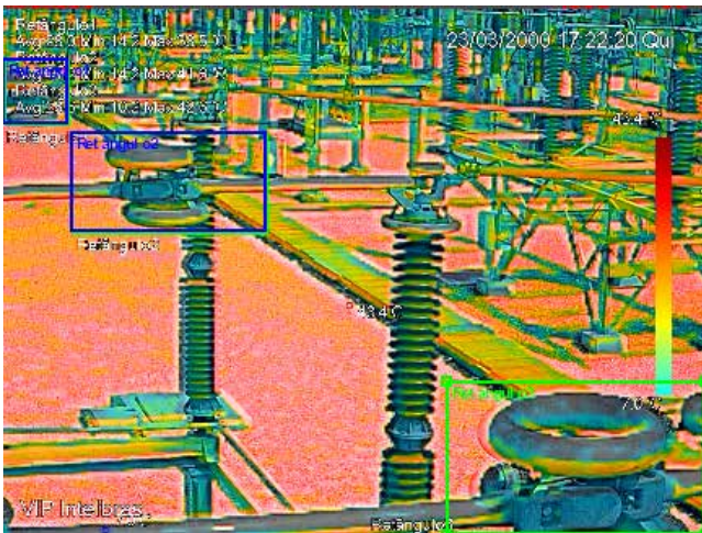
Figura 8 – Imagem capturada por uma câmera termográfica instalada na subestação com as áreas de interesse delimitadas.
