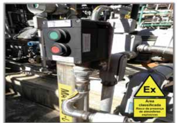
Exemplo de montagem de botoeira local de comando Ex “de”. Ao fundo, exemplo de instalação de motor de indução trifásico com marcações Ex “eb”, Ex “ec” ou Ex “tb”.
