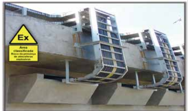
Exemplo de montagem de caixas de areia para passagem de cabos para circuitos de elétrica, instrumentação, automação ou telecomunicações em fronteiras entre áreas classificadas e áreas não classificadas.
