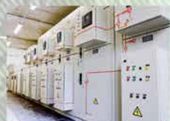
Cabines, Subestações e Cubículos de Média Tensão
