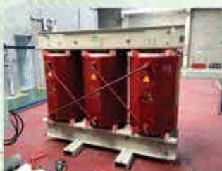
Transformador a Seco de Média Tensão
