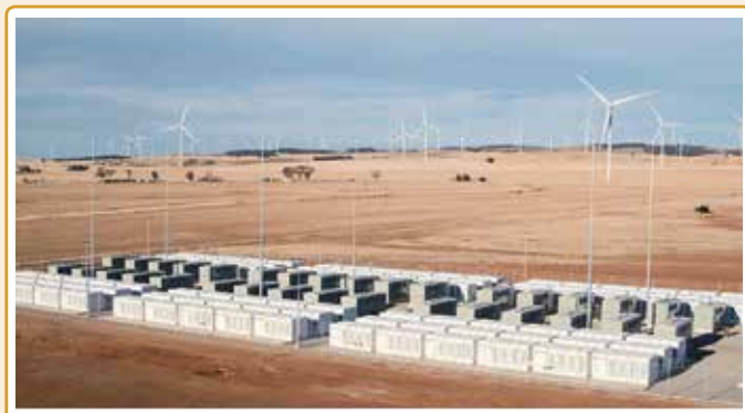
Figura 1 – Sistema de Armazenamento de Energia por Bateria (BESS) com 309 MW no parque eólico de construída pela Tesla, no sul da Austrália.
