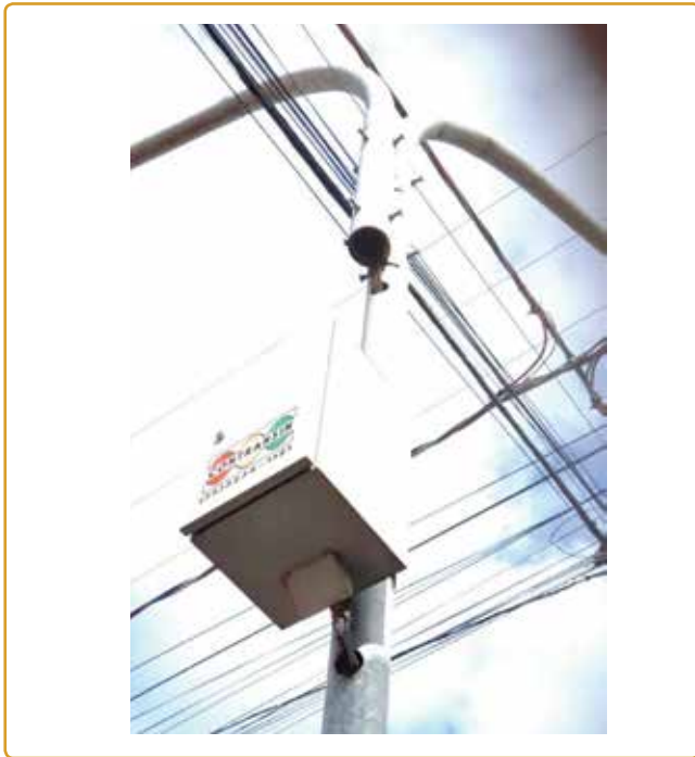
Figura 5 – Caixa de ligação na estrutura metálica do semáforo – sem proteção entre condutores de alimentação e borda metálica.
