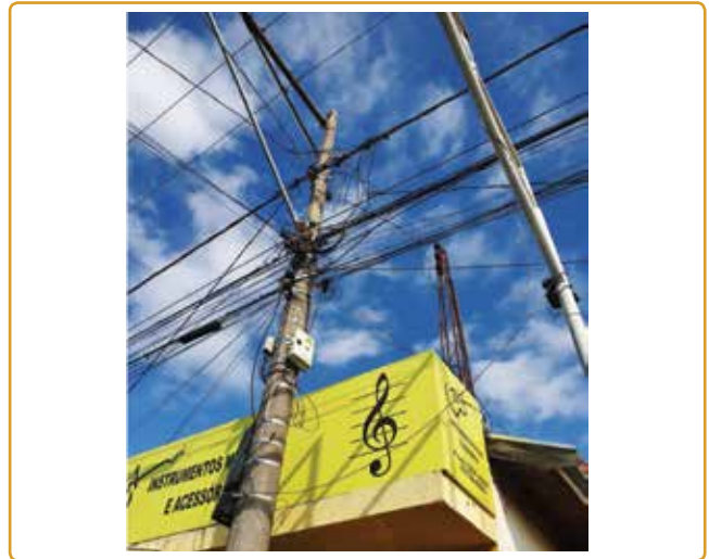
Figura 4 - Caixa de ligação dos condutores, alimentação dos semáforos instalados no poste.
