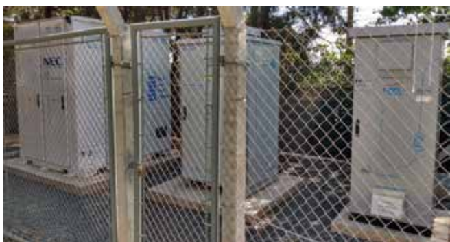
Figura 3 - BESS instalado no condomínio com alta penetração solar.
