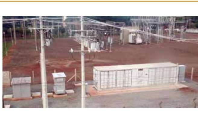
Figura 2 - BESS instalado na SE Barão Geraldo.
