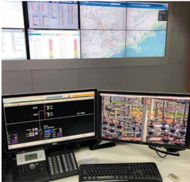
Figura 1 - Centro de operação de concessionária de energia elétrica.
