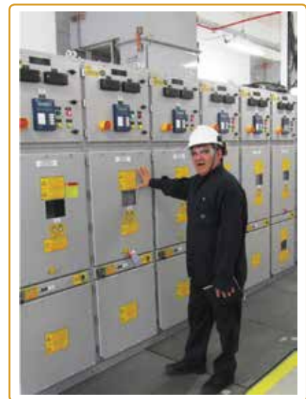
Figura 3 – Painel elétrico MT tipo IAC.
