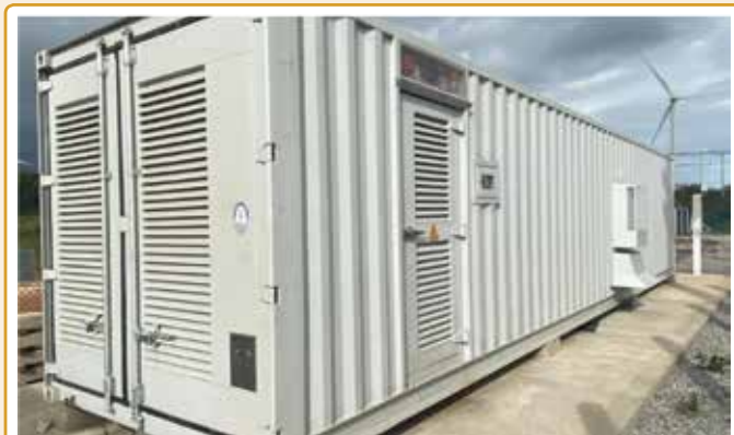
Figura 1 - BESS instalado na SE de Campos dos ventos com os geradores ao fundo.
