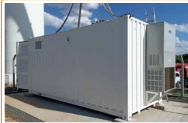
Figura 4 - BESS instalado na área técnica do cliente selecionado, junto ao gerador a diesel.
