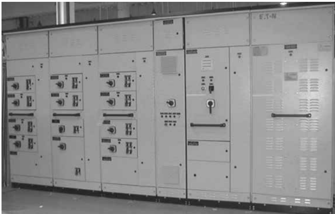
Figura 6 – CCM de BT típico do setor marítimo. Na coluna de entrada do conjunto (a primeira à direita), tem-se um reator limitador de corrente trifásico (atentar para as venezianas de ventilação).
