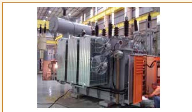
Figura 7 – Transformador novo de 69 kV.
