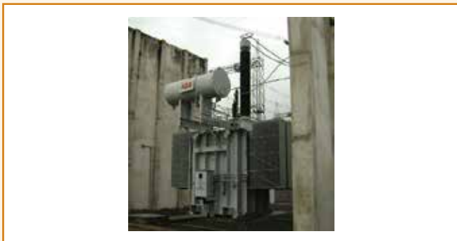
Figura 9 – Reator ASEA/BROWN BOVERI, tipo RM46 (154 kV-20 kV).
