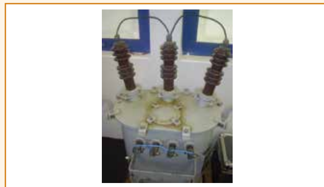
Figura 4 – Transformador preparado para teste.
