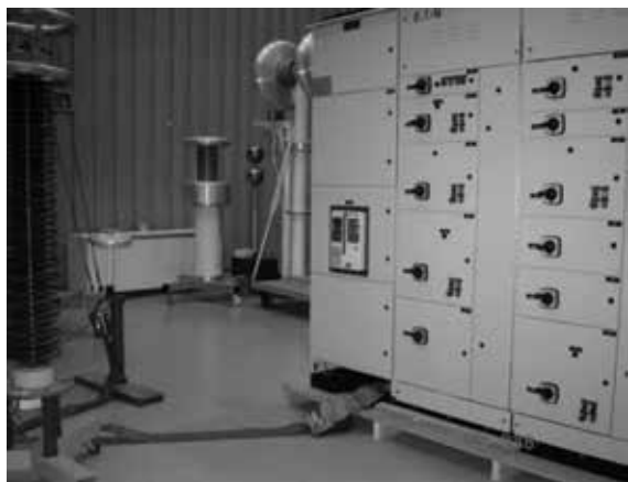
CCM – Centro de Controle de Motores
