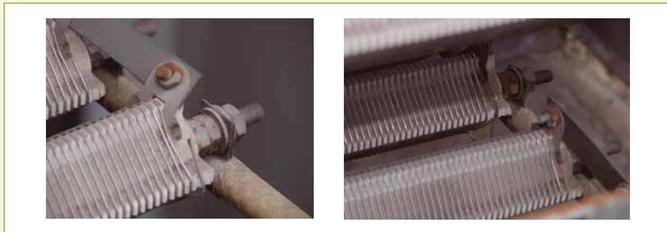
Figura 2 – Exemplos reais de resistores interrompidos.
