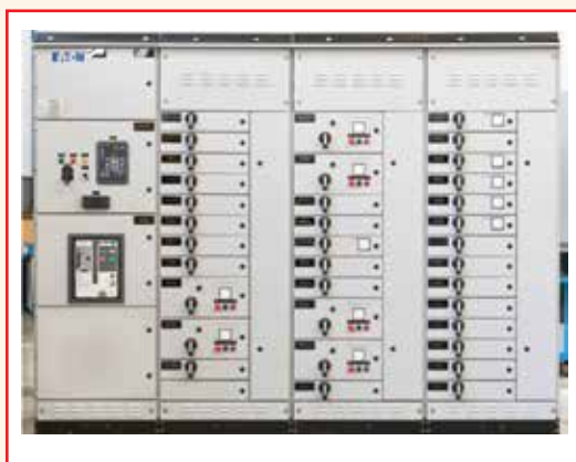
Figura 1 – Vista frontal de um CMCP de baixa tensão.
