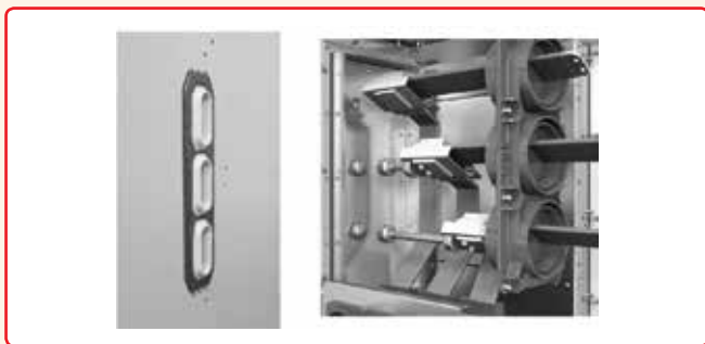
Figura 6 – Vista de buchas de passagem (barreiras entre colunas adjacentes) e barras isoladas no compartimento do barramento principal.
