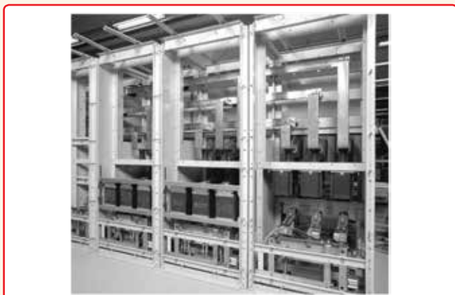
Figura 5 – Vista traseira de um típico conjunto de manobra, conforme IEC.
