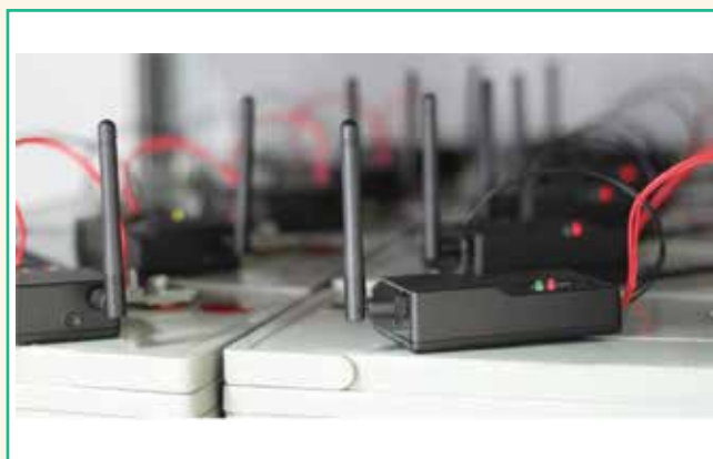
Figura 6 – Banco de baterias com medidores individuais.
