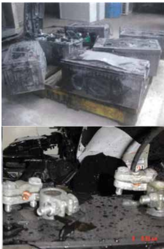
Figura 3 – Imagens de baterias danificadas.
