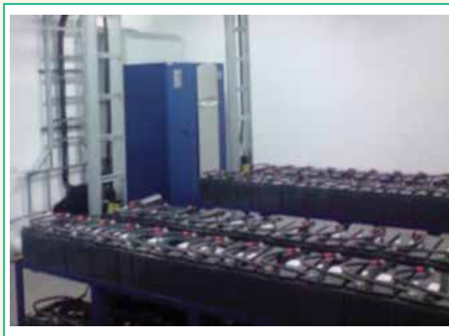
Figura 2 – Imagem de uma instalação de um UPS com baterias VRLA.
