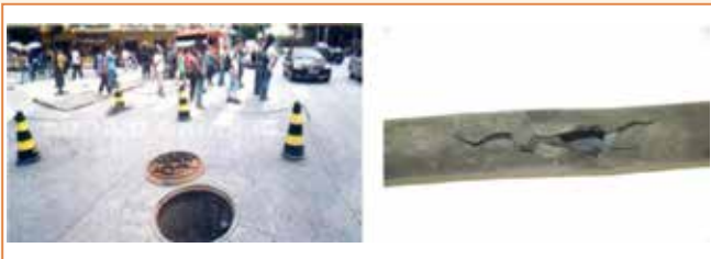
Figura 8 – Ocorrência em utilidade e cabo subterrâneo com falha estrutural no isolamento.
