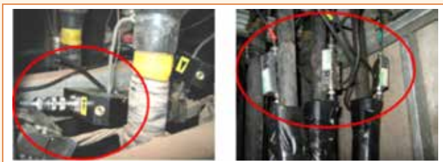
Figura 6 – Sensores instalados em condutores de média tensão.
