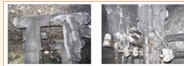
Figura 7 – Terminais e conexões de cabos subterrâneos com falhas estruturais de isolamento.
