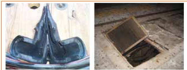
Figura 1 – Exemplos de danos a equipamentos e utilidades por falhas de isolamento elétrica.
