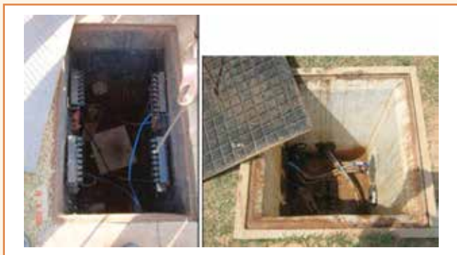
Figura 8 – Caixas de passagem (rede secundária).
