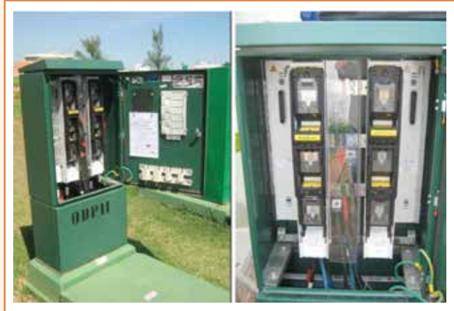
Figura 5 – Quadro de Distribuição e Proteção (QDP).
