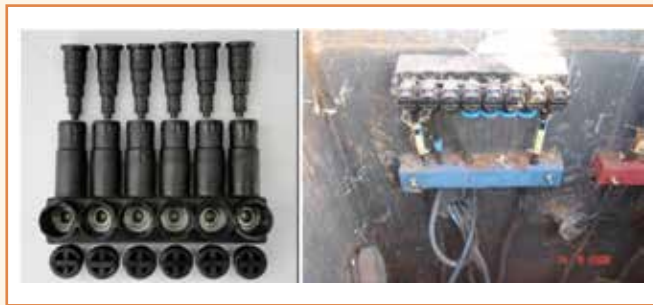
Figura 6 – Barramento múltiplo isolado.
