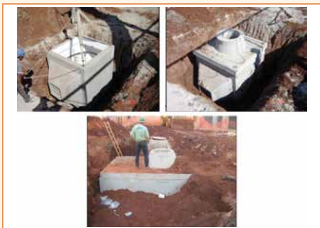
Figura 9 – Caixas de inspeção (rede primária).
