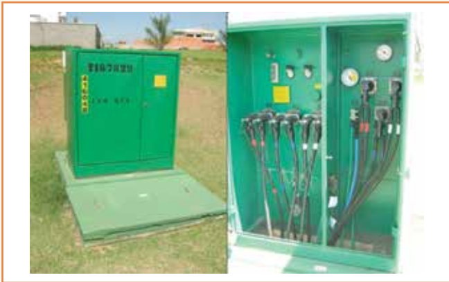
Figura 4 – Transformador tipo pedestal (Padmounted).
