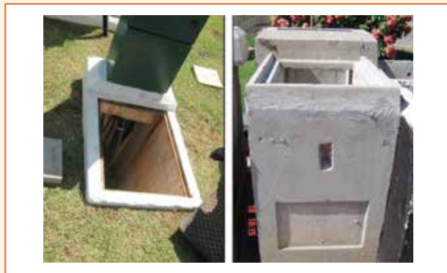
Figura 10 – Base de Quadro de Distribuição e Proteção (QDP).
