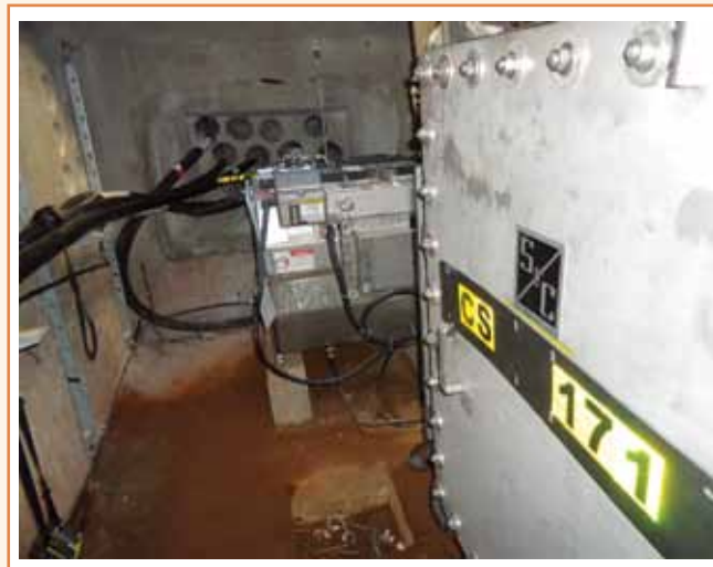
Figura 21 – Chave automática instalada em câmara.
