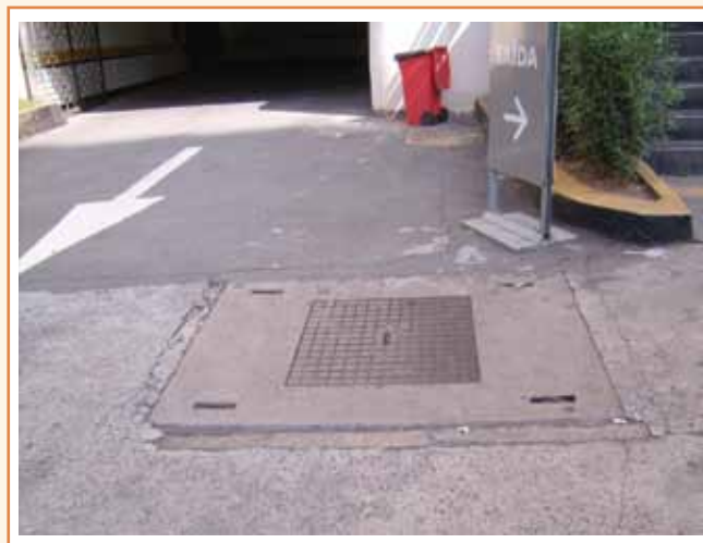
Figura 22 – Câmara subterrânea contendo chave automática.
