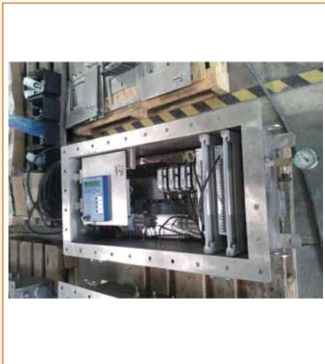
Figura 18 – Vista interna da caixa de automação da câmara subterrânea.
