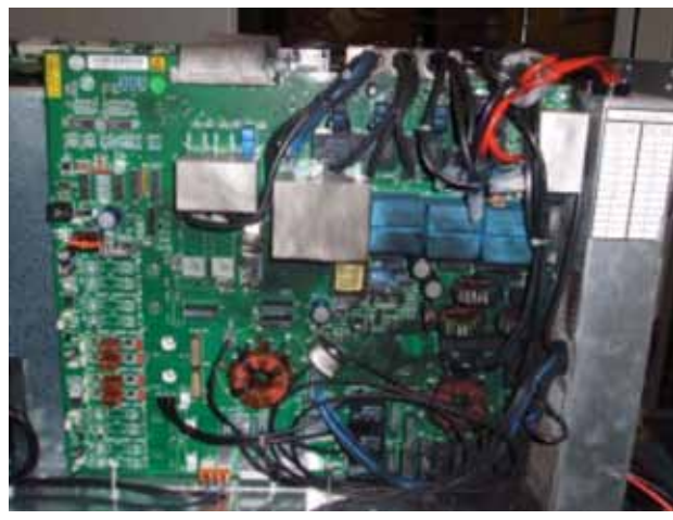
Figura 1 – Falha do UPS devido à inserção de material diferente e condutivo.
