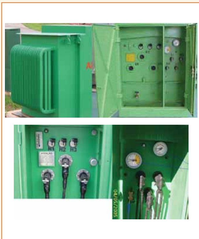
Figura 4 – Transformador de distribuição.
