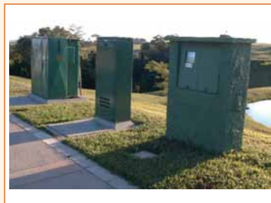
Figura 1 – Quadros de distribuição em pedestal.
