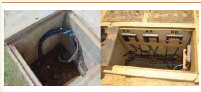
Figura 2 – Poço de inspeção e caixa de passagem.
