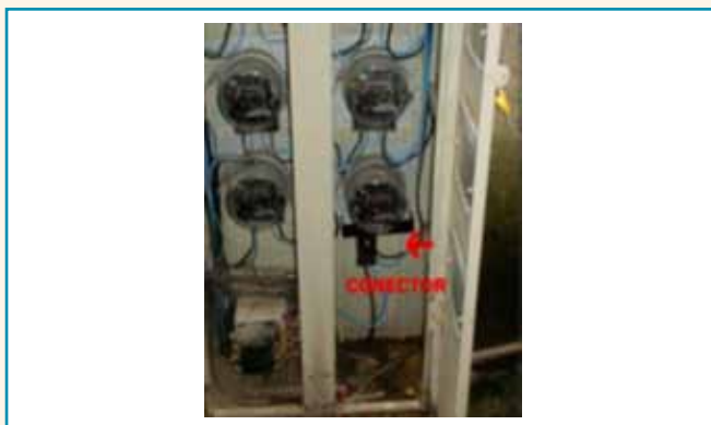
Figura 14 – Armário padrão com o conector instalado em um dos medidores.
