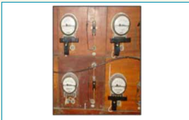
Figura 13 – Quadro de medidores com os conectores instalados.
