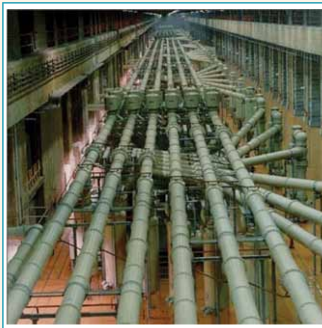
Figura 5 – Isolamento a gás SF6.
