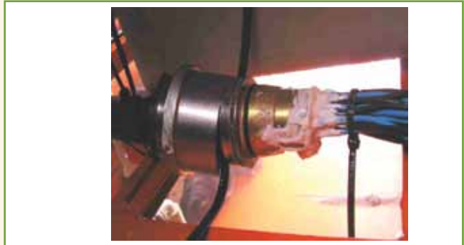
Figura 4 - Exemplo de falha de montagem de prensa-cabo com certificação “Ex”: utilização indevida de material de “selagem”.
