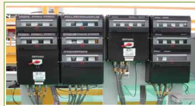
Figura 12 - Exemplo de montagem de painéis de força e comando com invólucros plásticos e componentes encapsulados de fábrica com proteção combinada Ex “de”. Vantagens: dispensa a necessidade de invólucros metálicos, de grande quantidade de parafusos de fixação das tampas, de unidades seladoras nas entradas de eletrodutos ou de prensa-cabos Ex “d” nos dispositivos de entrada de cabos. Fonte: Petrobras/RPBC
