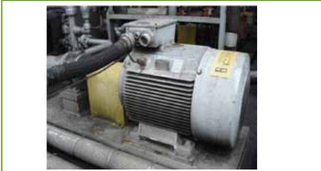
Figura 2 - Exemplo de falha de montagem de motor de indução trifásico com certificação “Ex”: ausência de fechamento de entrada de cabos na caixa de ligação de força.
