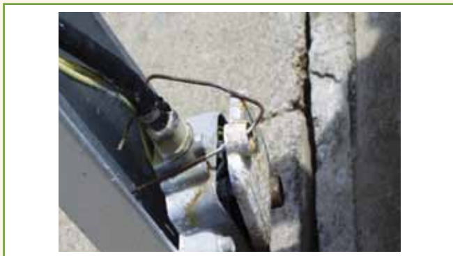
Figura 6 - Exemplo de falha de montagem de caixa de ligação com certificação "Ex": erros nas entradas de cabos e no fechamento da tampa.
