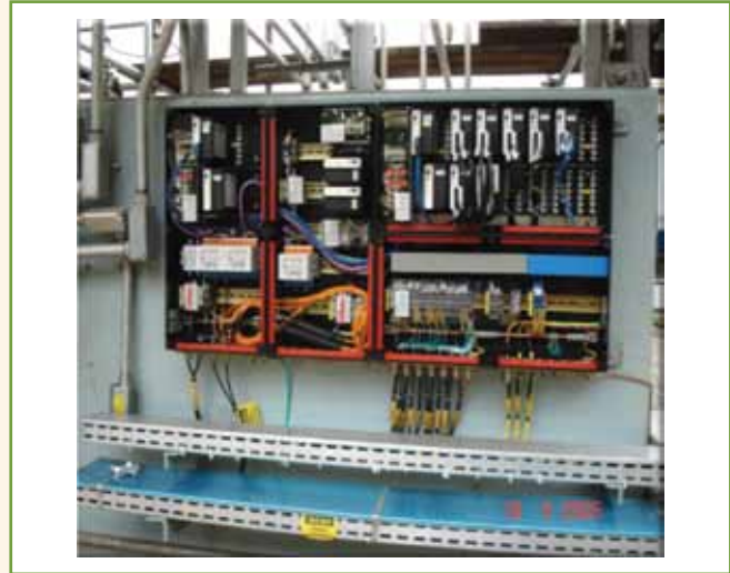
Figura 15 - Exemplo de montagem de sistemas intrinsecamente seguros com isoladores galvânicos [Ex “i”] instalados no campo, em áreas classificadas. Vantagens: dispensa a utilização de instrumentos com invólucros à prova de explosão, prensa-cabos e unidades seladoras Ex “d”. Fonte: Petrobras/RPBC
