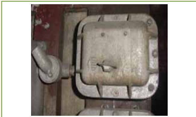
Figura 8 - Exemplo de falha de montagem de invólucro à prova de explosão, com certificação "Ex": parafusos de fixação de tampa flangeada e hastes de acionamentos quebrados.
