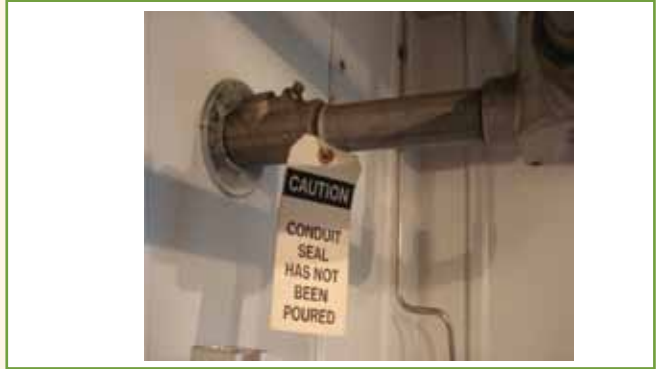
Figura 3 - Exemplo de falha de montagem de unidade seladora à prova de explosão com certificação “Ex”: ausência de colocação da massa seladora em seu interior, após conclusão de instalação de um “skid” importado.
