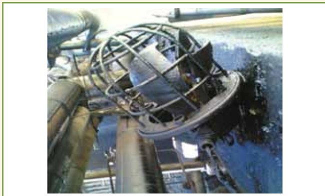
Figura 7 - Exemplo de falha de montagem e de manutenção de luminária fixa com certificação "Ex": falta de fixação a suportes, falta de prensa-cabo e de vedação na entrada de cabos e componentes quebrados.
