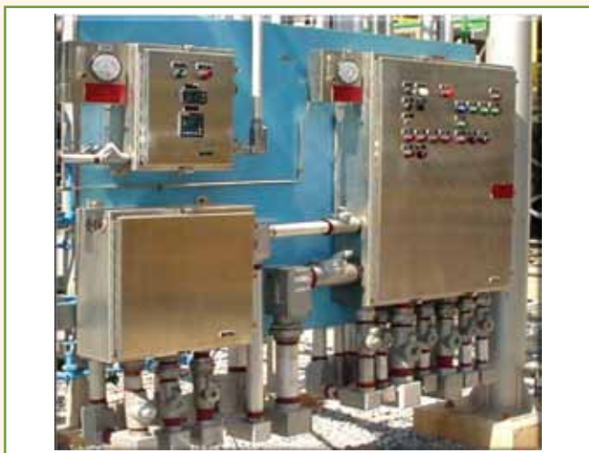
Figura 16 - Exemplo de montagem de painéis de controle de instrumentação com invólucros pressurizados do tipo Ex "pz" Gc. Vantagens: dispensa a necessidade de instalação de invólucros metálicos à prova de explosão. Fonte: Petrobras/RPBC
