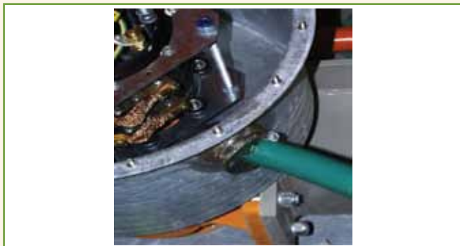
Figura 5 - Exemplo de falha de montagem de entrada de cabos em um invólucro com grau de proteção IP 55: falta de prensa-cabo e utilização indevida de material de vedação.
