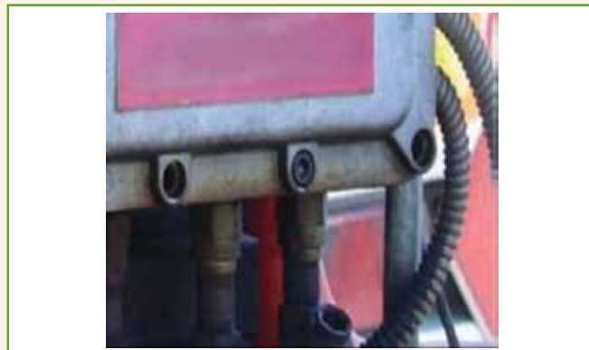
Figura 9 - Exemplo de falha de montagem de invólucro à prova de explosão, com certificação "Ex": falta de parafusos de fixação de tampa flangeada.
