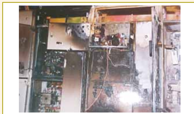
Figura 12 – Queima de várias colunas devido a falta à terra por arco.
