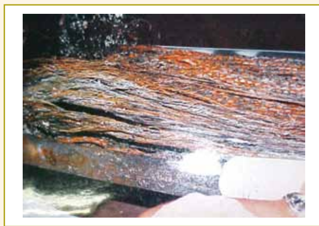
Figura 14 – Situação dos cabos do leito sobre o painel que sofreu curto à terra por arco.
