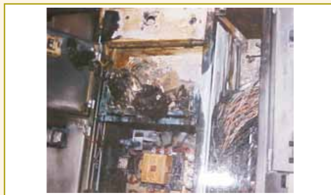
Figura 11 – Queima de uma coluna devido a curto à terra por arco.
