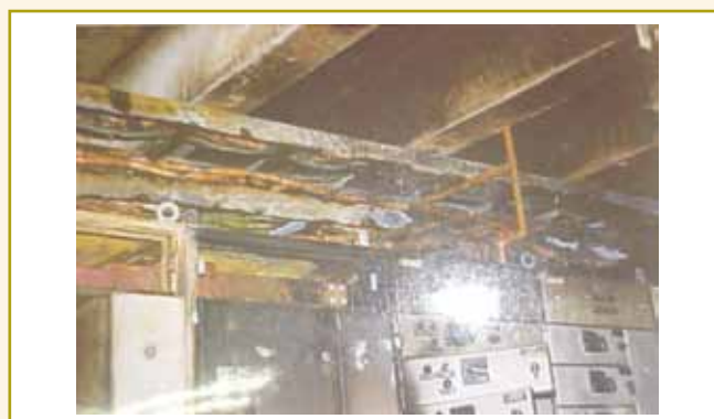
Figura 13 – Queima de várias colunas devido a falta à terra por arco e queima de cabos no leito sobre o painel.
