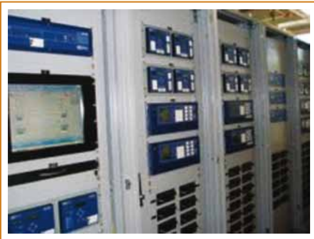
Figura 3 – Painel de controle convencional e com IEDs.
