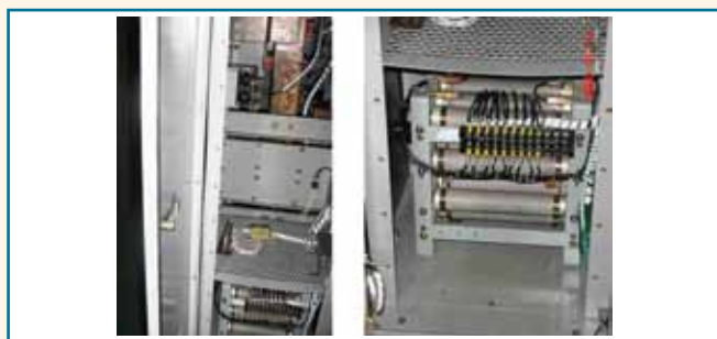
Figura 4 - Sistema instalado em vários CMCs de BT, tipo CDC, para quatro plantas petroquímicas na China.
