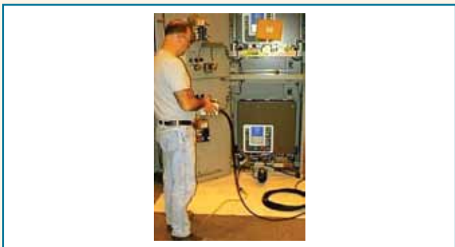
Figura 3 – Opção para operação remota de movimentação de elemento de manobra extraível (permitindo ao operador se posicionar fora da zona de risco de arco)
