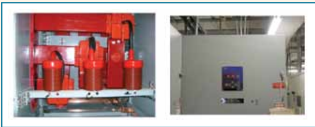
Figura 6 – Instalação dos acopladores capacitivos e unidade de coleta e centralização de dados para monitoração contínua dos níveis de descargas parciais num CMCP de MT. Os dados podem ser repassados, via rede de comunicação, para um sistema supervisorio.
