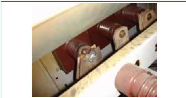
Figura 7 – Conexão de saída de um CCM de MT com sinais de aquecimento por uso de parafuso de fixação com dimensões incorretas (maior comprimento do corpo).
