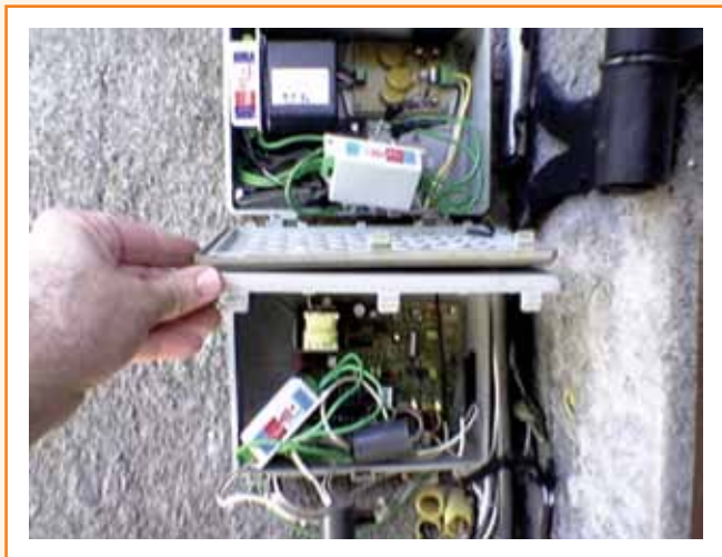
Exemplo do uso de DPSs adequados, mas instalados de forma inadequada
