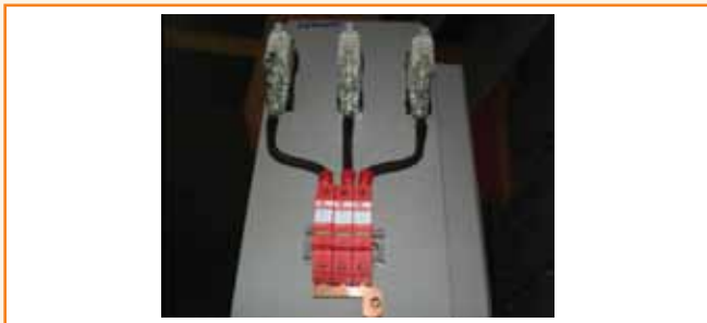
Quadro do trafo auxiliar em casa de comando de sistemas eletrônicos (inclusive sem DPS)
