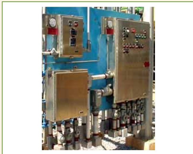
Figura 4 - Instalação de painel local de controle Ex do tipo pressurizado com marcação Ex pz T4 EPL Gc
