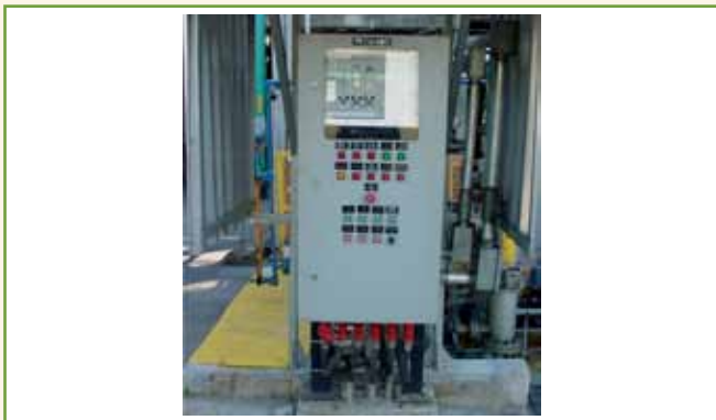
Figura 2 - Instalação de painel local de controle Ex do tipo pressurizado e com marcação Ex pz de IIC T4 EPL Gc
