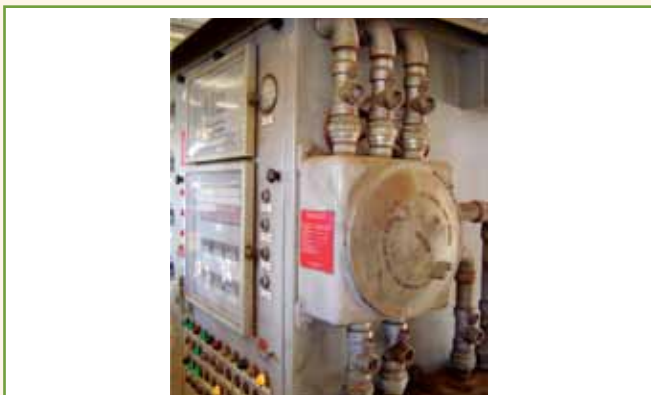
Figura 3 - Instalação de painel local de controle Ex do tipo pressurizado com marcação Ex pz d IIA T3 EPL Gc
