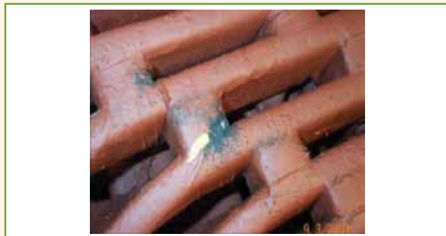
Figura 17 – Exemplo de dano verificado em enrolamentos do estator de motor industrial trifásico de 13,8 kV, tipo de proteção Ex “p”, causado por concentração de campo elétrico e efeito corona, detectado por meio de ensaios de Descargas Parciais (PD), de acordo com a IEC 60034-27 .
