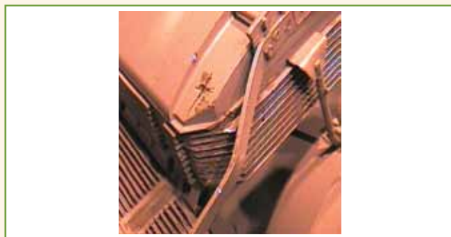
Figura 18 – Exemplo de dano a ser reparado em polo saliente de motor síncrono de 13.8 kV com tipo de proteção Ex “p” .
