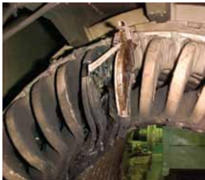
Figura 2 – Enrolamento de estator motor de indução trifásico não acendível, com tipo de proteção Ex “nA”, apresentando danos na cabeça de bobinas, ocasionado por sobrecarga e partidas frequentes, requerendo reparo de reenrolamento. Fonte: Petrobras/Refinaria Presidente Bernardes de Cubatão.
