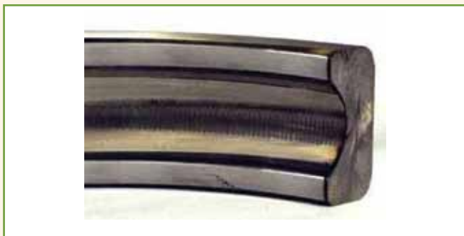
Figura 21 – Exemplos de erosão ocorrida em colo de rolamento de mancal de motor Ex “nA” acionado por conversor de frequência devido à circulação de correntes de fuga entre o eixo e os mancais do motor causada pelo chaveamento de tensão com elevada frequência .
