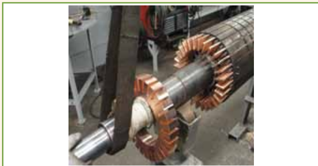
Figura 6 – Serviço de montagem e reparo de rotor de motor de indução trifásico Ex “nA”, 800 kW / 4,0 kV: substituição das barras de cobre do rotor e fechamento da gaiola de esquilo. Fonte: Petrobras.
