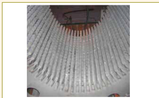
Figura 19 – Pontos de aquecimento, destacados com giz branco, detectados com pirômetro, durante a realização de ensaio de fluxo em pacote magnético das chapas do estator de motor elétrico “Ex” de alta tensão (Fonte: Petrobras).
