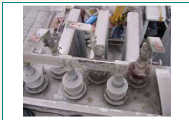
Figura 29 – Ponto de contato de aterramento referente à Figura 28
