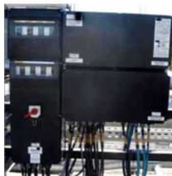
Instalação de equipamento “Ex” com tipos de proteção “Ex dem [ialib] IIC T5/T4”, EPL Gb. – Refinaria Presidente Bernardes de Cubatão
