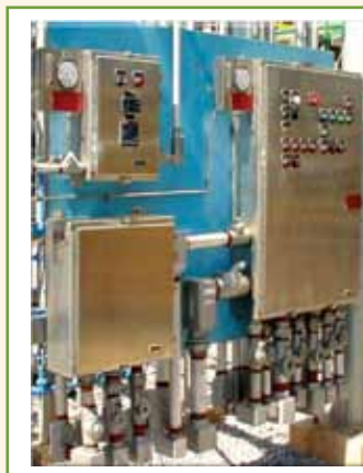
Instalação de painel local de controle “Ex” do tipo pressurizado com marcação “Ex pz T4” EPL Gc. – Refinaria Presidente Bernardes de Cubatão
