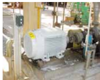
Instalação de motor “Ex” do tipo segurança aumentada com marcação “Ex e II T3”, EPL Gb. – Refinaria Presidente Bernardes de Cubatão
