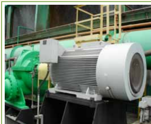
Instalação de motor de indução trifásico "Ex" do tipo não acendível com marcação "Ex nA II T3" EPL Gc. – Refinaria Presidente Bernardes de Cubatão
