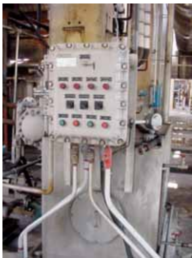
Instalação de painel local de controle “Ex” do tipo à prova de explosão, com tipos de proteção “Ex d IIA T3”, EPL Gb. – Refinaria Presidente Bernardes de Cubatão
