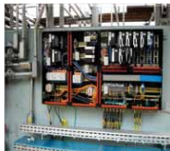
Instalação de Unidade Terminal Remota “Ex” do tipo intrinsecamente segura com tipos de proteção “Ex dem [ib] IIC T5”, EPL Gb. – Refinaria Presidente Bernardes de Cubatão
