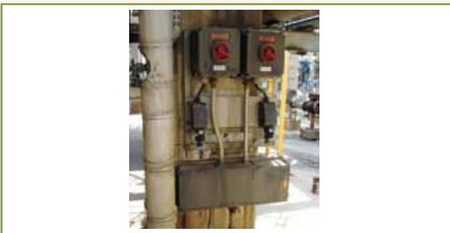
Figura 11 – Tomadas para máquinas de solda com tipo de proteção por segurança aumentada e à prova de explosão – EPL Gb, instaladas com chaves de proteção e caixas de passagem, por meio de sistema de eletrodutos em áreas “Ex” do tipo Zona 2.
