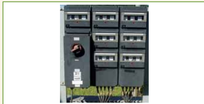
Figura 7 – Painel de distribuição de circuitos trifásicos de força para alimentação de sistema de telecomando de válvulas motorizadas, com tipo de proteção combinada à prova de explosão e segurança aumentada. Marcação Ex de IIC T5 EPL Gb, instalado em áreas classificadas do tipo Zona 1 e Zona 2 que requerem EPL Gb e Gc.
