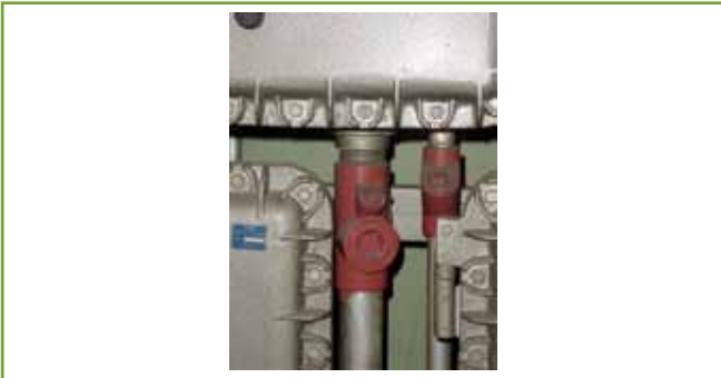
Figura 9 – Unidades seladoras: instaladas o mais próximo possível das entradas de eletroduto do respectivo invólucro Ex “d”: objetivo de minimizar o volume de gás acumulado e de instalação de acessórios Ex “d” entre o invólucro e a unidade seladora.
