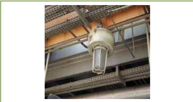
Figura 10 – Luminária do tipo vapor de sódio com lâmpada de 70 W, tipo de proteção Ex “nR” EPL Gc, instalada com sistema de distribuição de cabos por bandejas em instalações “Ex” do tipo Zona 2.
