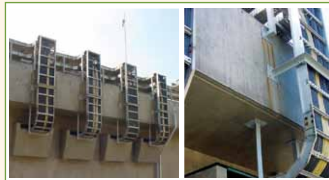
Figura 5 – Caixas de areia para a entrada de multicabos de instrumentação, provenientes de áreas classificadas, em Casa de Controle Local (área não classificada).
