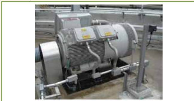
Figura 15 – Motor de indução trifásico com tensão nominal de 4,16 kV e potência nominal de 300 kW, com tipo de proteção Ex “nA” II T3 EPL Gc, instalado em área classificada do tipo Zona 2. Circuitos de força e controle instalados em sistemas de eletrodutos.
