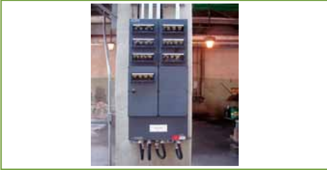
Figura 8 – Painel de distribuição de circuitos de iluminação e tomadas com tipo de proteção combinada à prova de explosão e segurança aumentada. Marcação Ex de IIC T5 EPL Gb, instalado em área classificada que requer EPL Gc.
