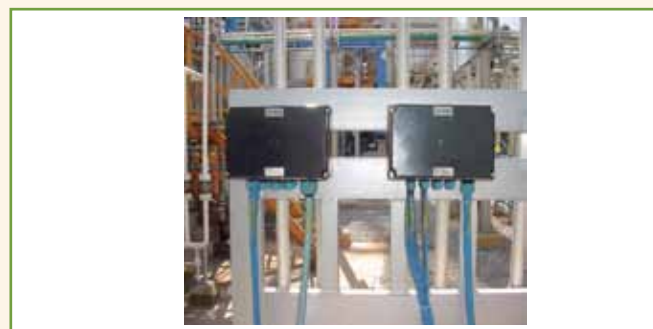
Figura 6 – Caixas de junção do tipo Segurança Aumentada, EPL Gb com prensa-cabos, cabos e multicabos com circuitos intrinsecamente seguros EPL Ga.
