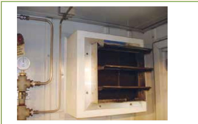
Figura 2 – Sistema de venezianas com fechamento automático para proteção de ambientes protegidos por pressurização.
