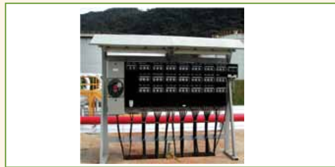
Figura 4 – Painel de distribuição de circuitos trifásicos de alimentação de atuadores de válvulas motorizadas, com marcação Ex de IIC T5 EPL Gb, instalado em área que requer equipamentos com EPL Gc.
