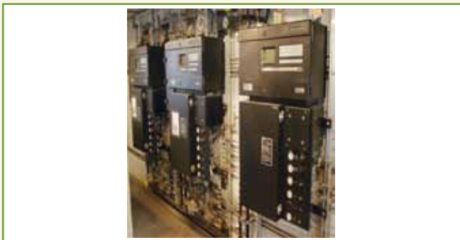
Figura 12 – Analisadores de hidrogênio com tipo de proteção Ex “nA” instalados no interior de um shelter com purga constante, contendo outros analisadores, tipo de proteção py EPL Gb, instalado em área classificada do tipo Zona 2 – Grupo IIC.
