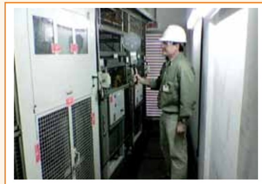
Figura 1 – Medição de campos magnéticos em frequência industrial
