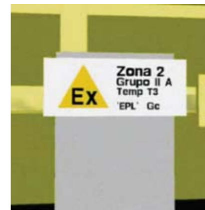
Placa de sinalização de área classificada contendo atmosfera explosiva de gás, com indicação de zona 2, grupo, classe de temperatura e EPL Gc requerido para os equipamentos elétricos e de instrumentação a serem instalados neste local
